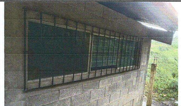
Foto 4: INSTALACION FINAL DE BALCON PARA BAÑO DE MUJERES DE 0.85 m x 3 m.
